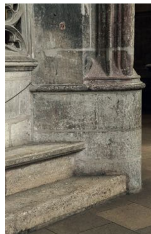
Kutná Hora. Kostel sv. Barbory. Sokl pilíře vysokého chóru.
